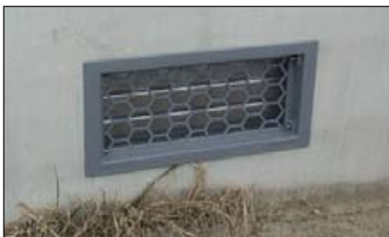
4. NON COMPLIANT VENT
